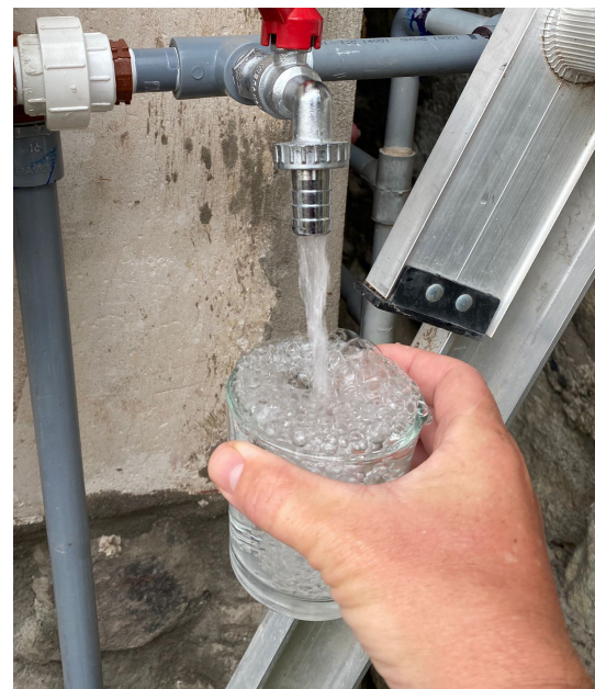
Nachher: Glasklares, sauberes Trinkwasser nach der Seccua Ultrafiltration
